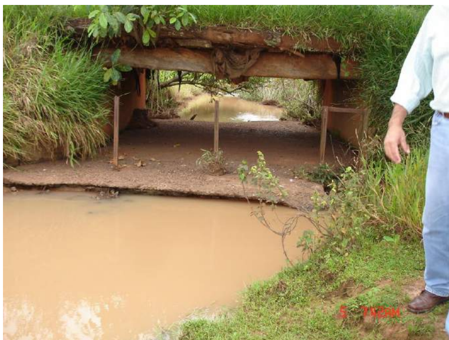
Figura 16. Vertedouro de superfície da represa da EENP, construído na década de 60, foi rompido parcialmente devido ao aumento do fluxo de água durante impacto no córrego Morais ocorrido em janeiro de 2010.
