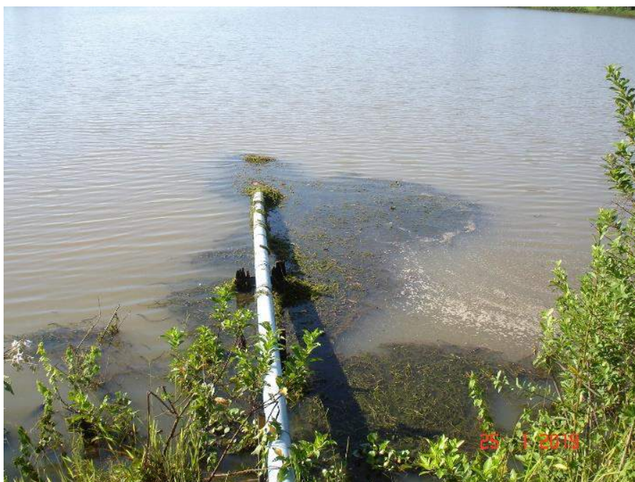
Figura 29. Dispositivo de segurança hídrica Q7;10 instalado ao lado do vertedouro de superfície da represa da Estação Ecológica que foi parcialmente soterrado e parou de funcionar, após os impactos ocorridos no córrego Moraes, em janeiro de 2019.
