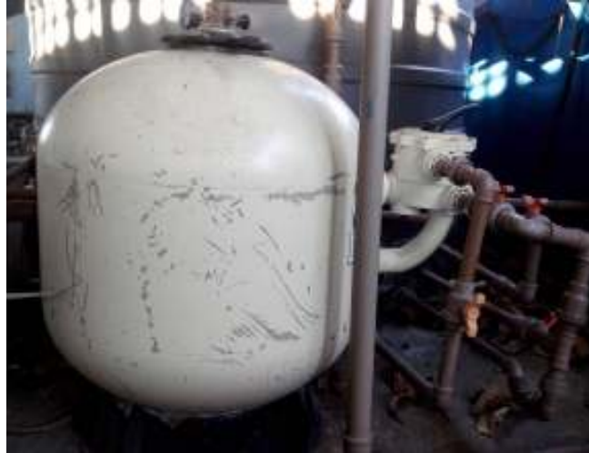
Figura 8. Filtro denitrificador. Fonte: Aquário de Ubatuba.
