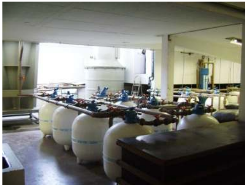
Figura 3. Bateria de filtros de areia (filtragem física). Fonte: Terramare
