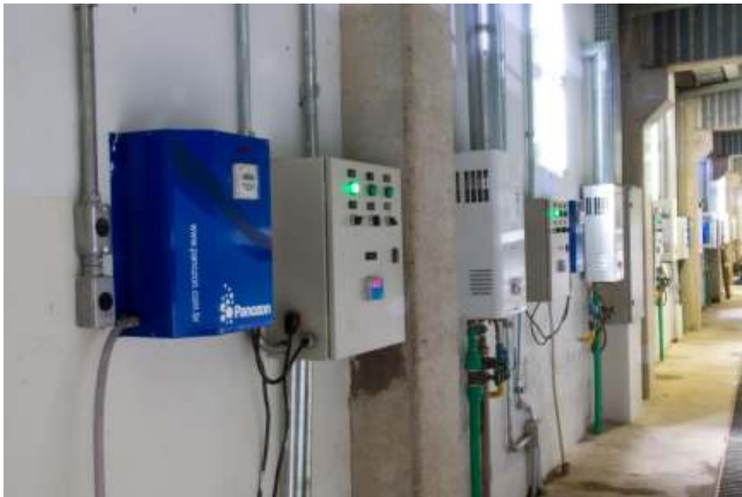
Figura 10. Sistema de esterilização com ozônio. Fonte: Terramare
