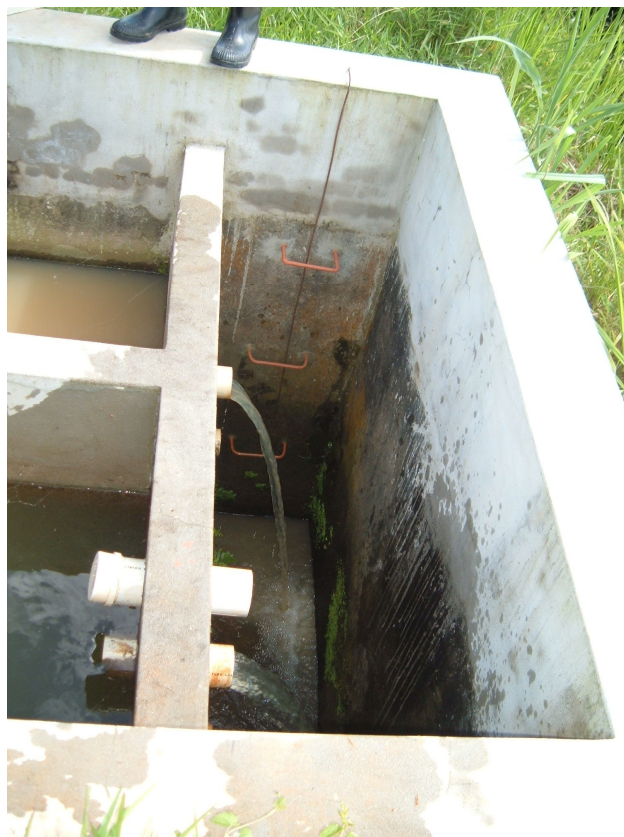
Figura 4: Detalhe do monge do viveiro, destacando o efluente.
