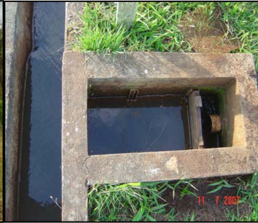
FIGURA 3b. Ponto P1 detalhamento da canaleta de abastecimento do viveiro com comporta de regulação manual.
