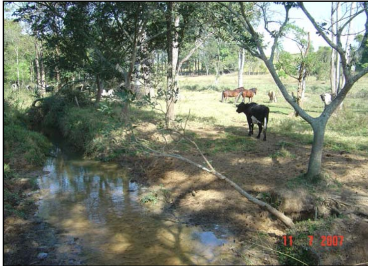
FIGURA 17a. Erosão das margens e do campo de pastagem.
